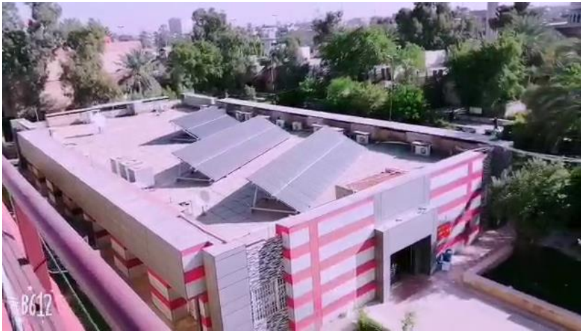
شكل رقم (٢-٥ب) منظومة الشمسية kW PV- Solar System ١٥ على مركز بغداد القديم
