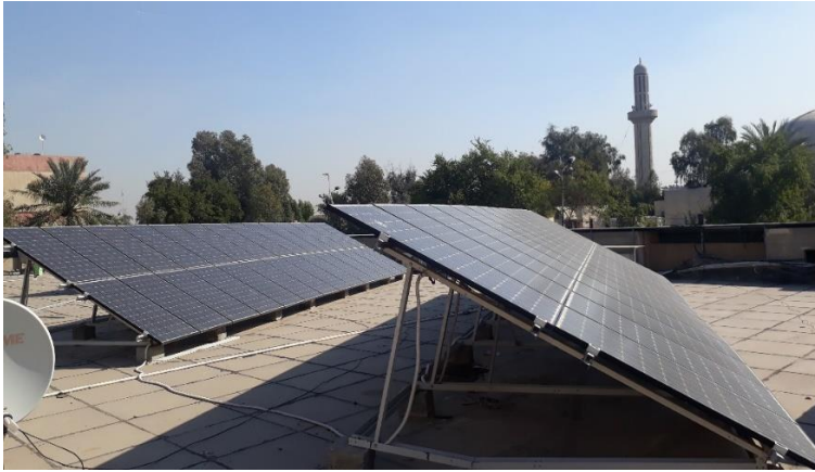
شكل رقم (٢-٥) منظومة الشمسية PV- Solar System
